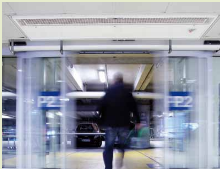
Udgangen til de tre parkeringsdæk under Bruun's Galleri har alle fået nye lufttæpper fra Venti med de rette dimensioner.
