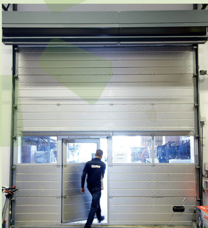
Som et led i at reducere CO 2 udledningen har SILVAN valgt at montere lufttæpper på de 4 x 4 meter store porte i vareindleveringen.
